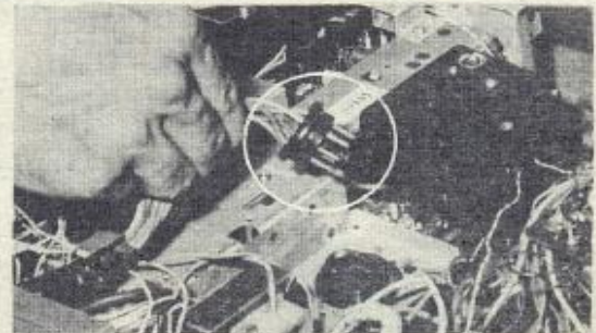
محل بیرون آوردن سوکت ترانس برق
